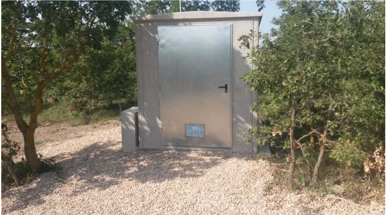
Caseta bombat accelerador de Piulats (1-7-2015)
