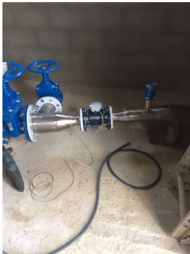
Línia Hostal Nou a Biosca. Valvuleria sortida caseta Hostal Nou (10-01-2017)
