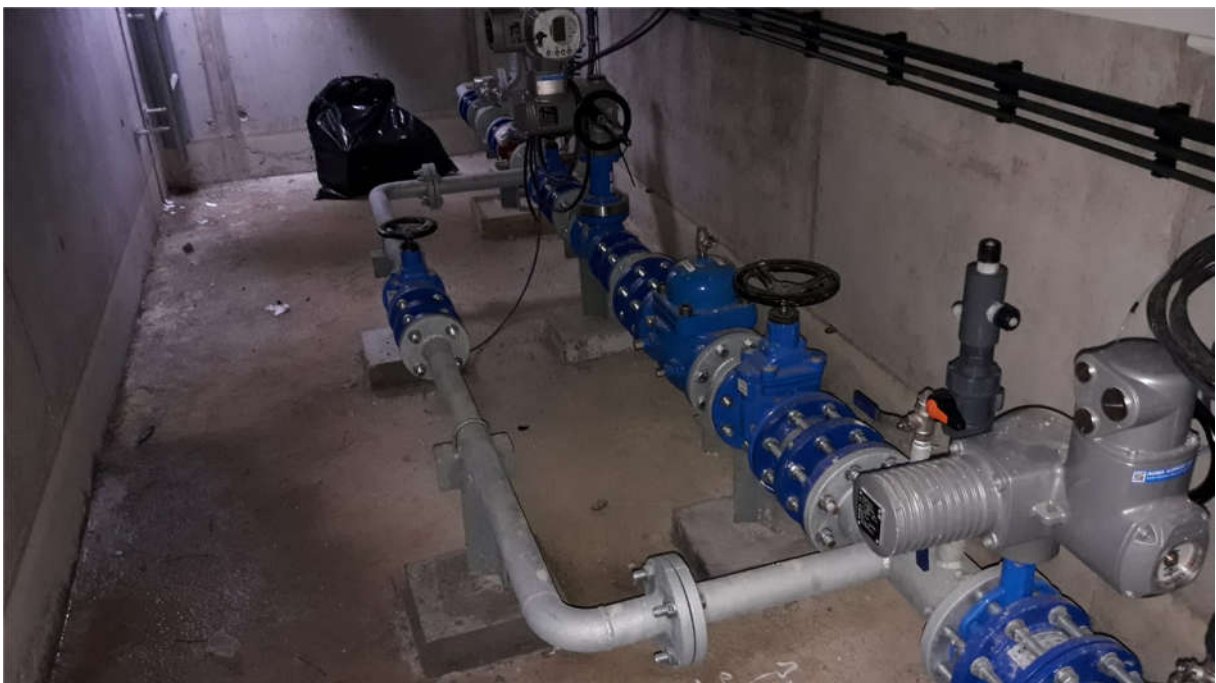
Arqueta de connexió a Cabot, de la xarxa de la Llosa del Cavall (10/12/2018)
