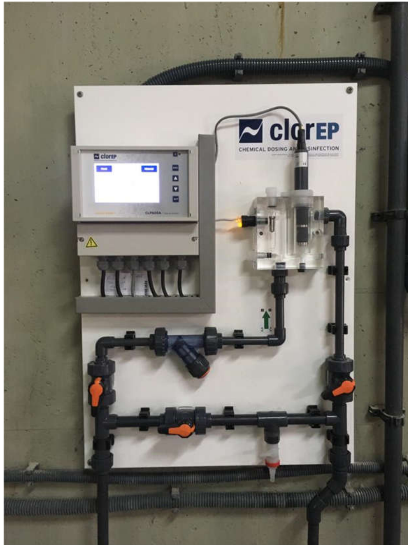
Nous analitzadors de clor al Pi, Repetidor i bombat Pinós
