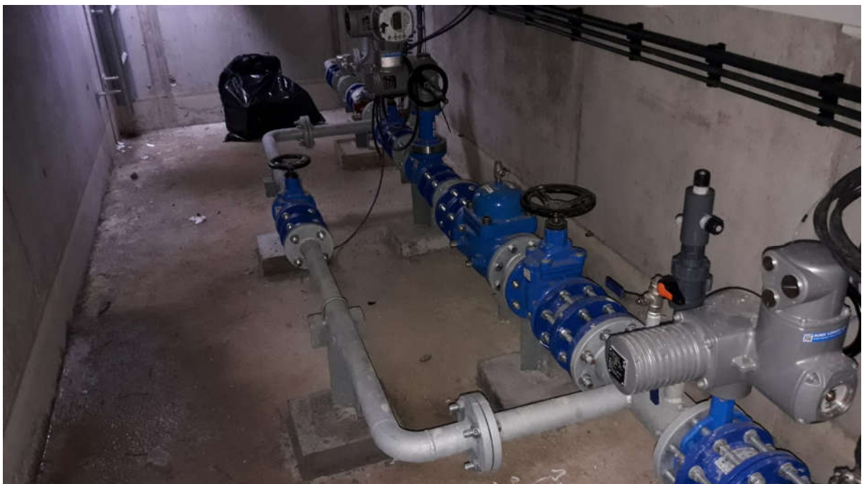
Arqueta de connexió de la xarxa de la Llosa del Cavall a Cabot, (10/2/2019)
