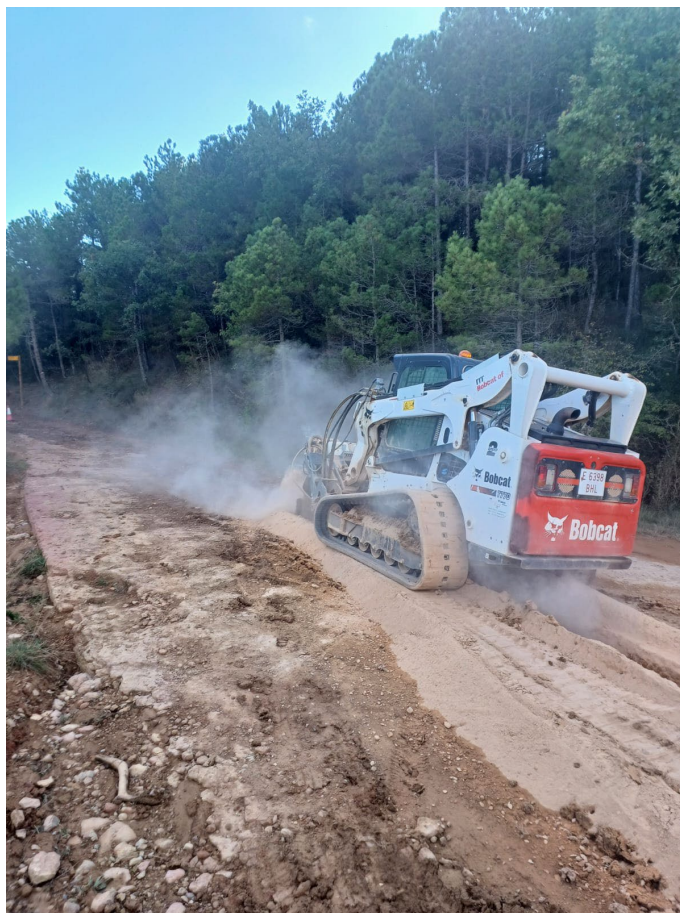
Rasadora d'emergència línia Llera a Lladurs (3-10-2024)
